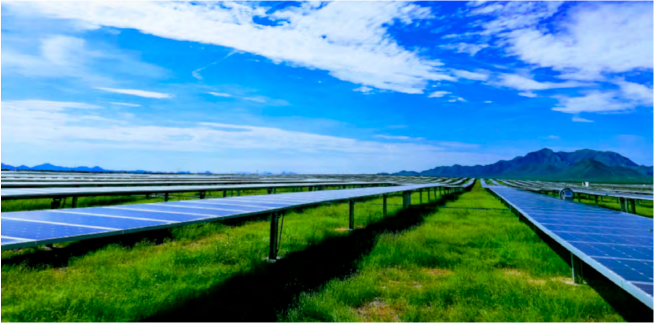
Parque fotovoltaico Hermosillo, Sonora, México
