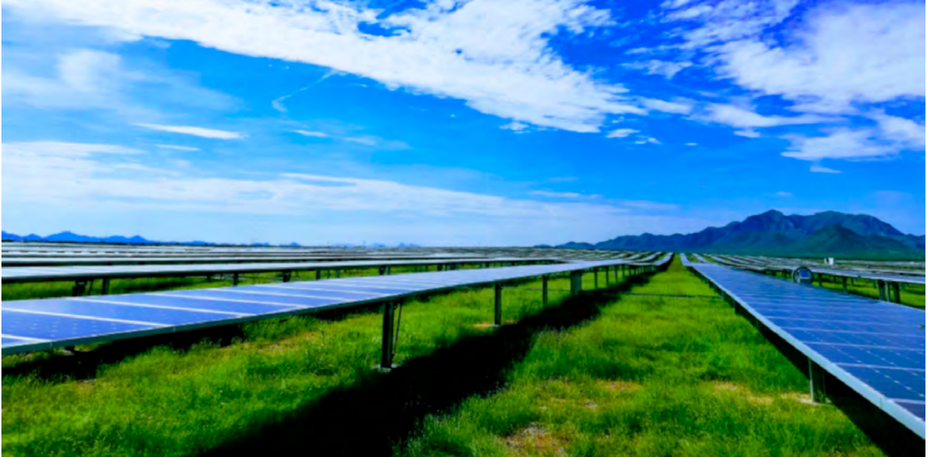
Parque fotovoltaico Hermosillo, Sonora, México
