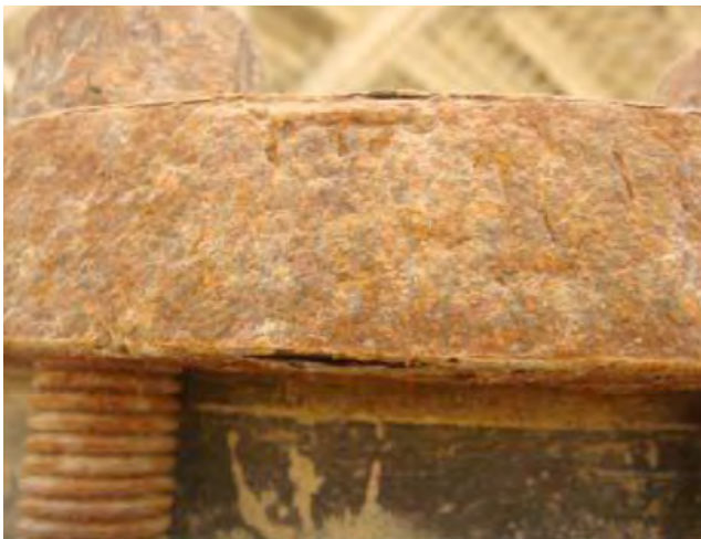
Corrosión generalizada en pernos y brida, CC Mesaieed
