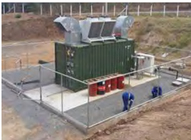
Planta de generación de electricidad a partir de biogás
