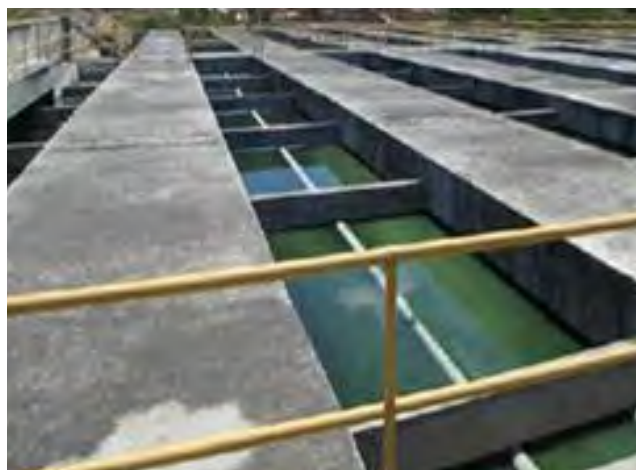
Biodigestor de aguas residuales
