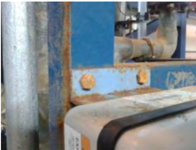
Soportes de caja en el edificio de electrocloración, CC Koudiet
