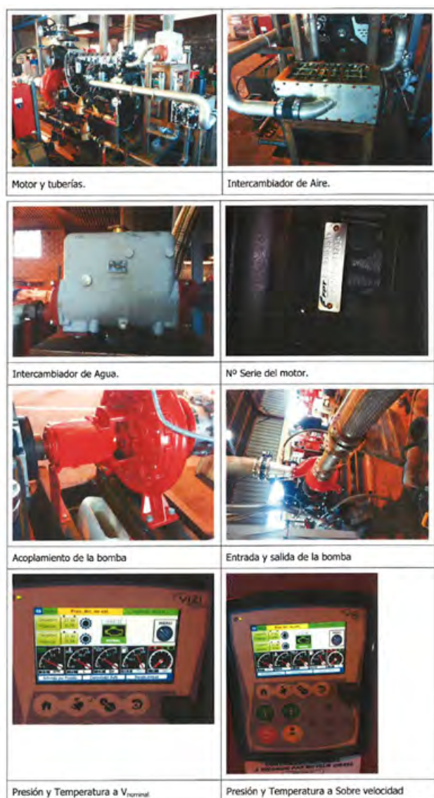
Elementos que componen el sistema de bombeo y el panel de control
