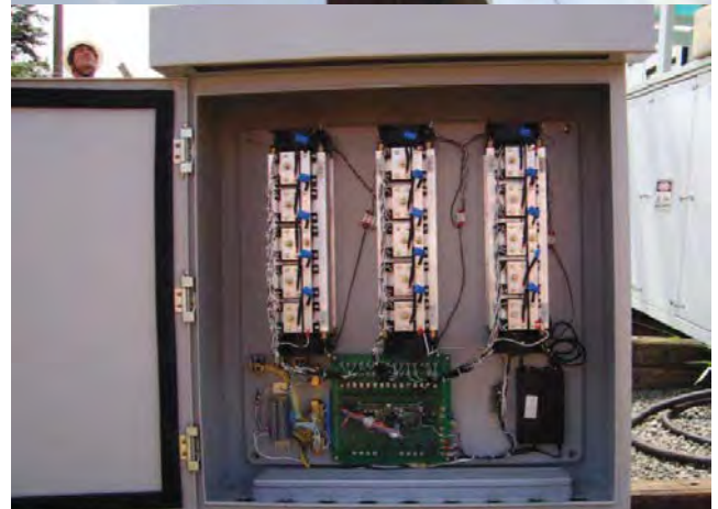
Regulador automático ya instalado
