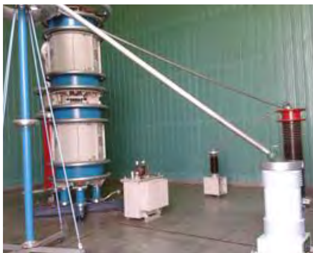
Equipo de medida y protección de transformadores
