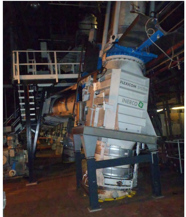
Nuevo sistema Flexicom instalado
