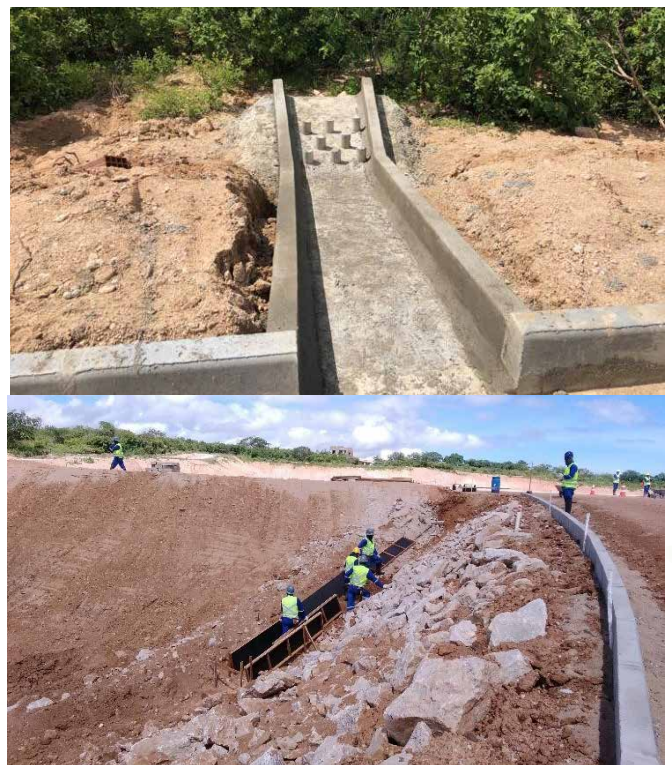
Sistema de drenaje instalado en Parques eólicos
