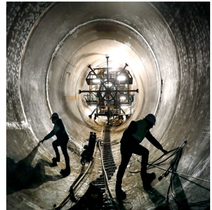
Tubería forzada CH Gouvães, ALTO TÂMEGA / Portugal
