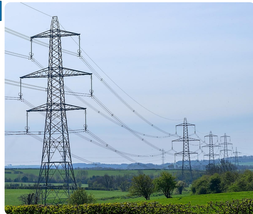
Línea de transporte que conecta las subestaciones de Neilston y Kilmarnock South (Escocia)
