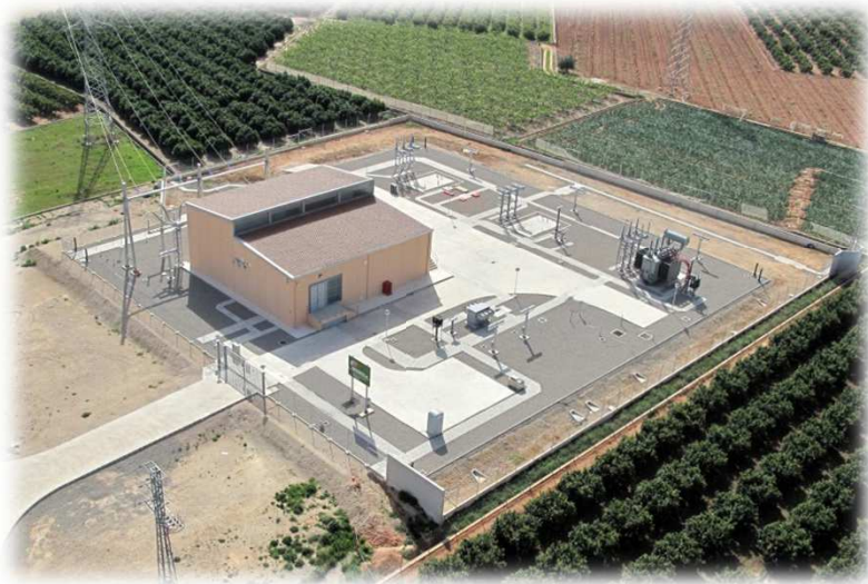
Subestación Compacta Benifaio, España
