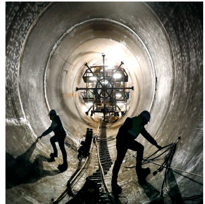
Tubería forzada CH Gouvães, ALTO TÂMEGA / Portugal
