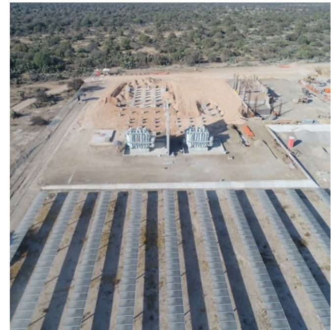
Planta solar y subestación en Santiago FV / Mexico
