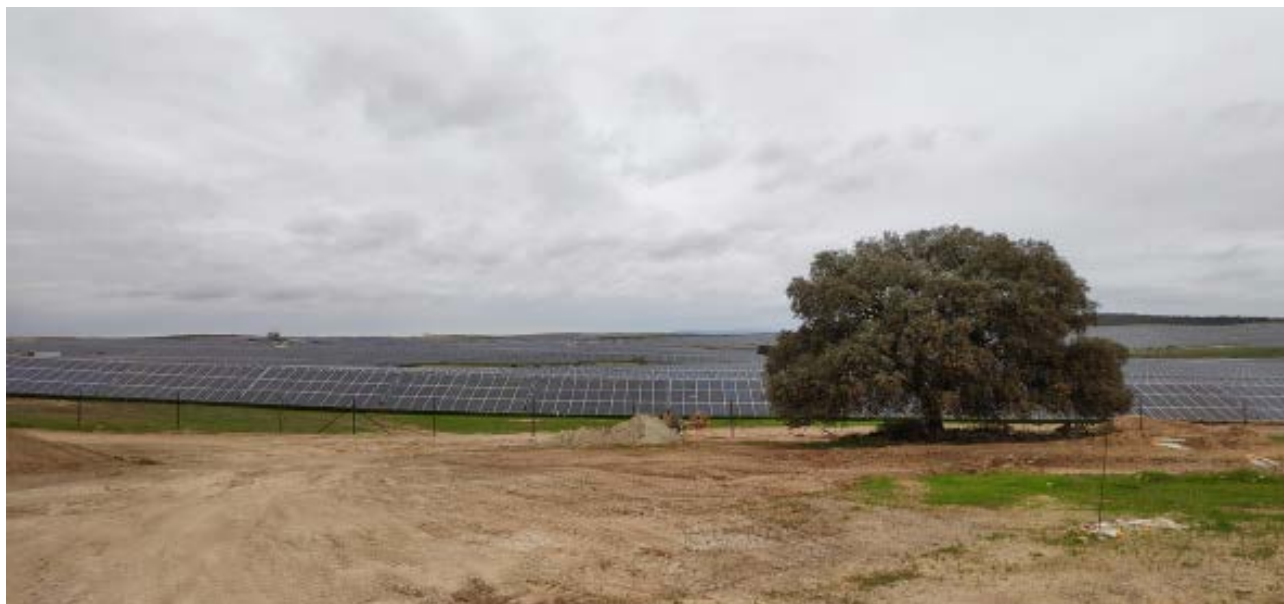
Central fotovoltaica Francisco Pizarro - Cáceres, España
